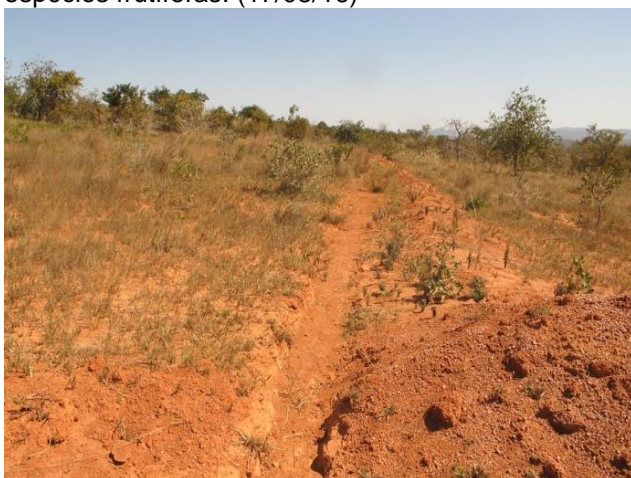
Foto 5: Vista de terraço a ser reconstruído (17/08/16)
